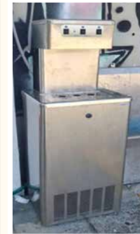
Ψύκτης που εγκαταστάθηκε στην αυλή του Σχολείου, έπειτα από ενέργειες της Λουκίας Καλούδη, υπεύθυνης του Οικολογικού σχολείου.
